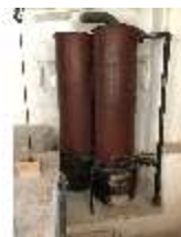
Lin.II, Technik, Heizung, DI015990, BSV-
