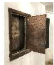
Lin.II, Technik, Heizung, DI015991, BSV-
