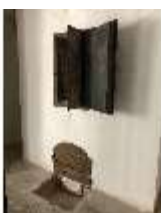
Lin.II, Technik, Heizung, DI015992, BSV-
