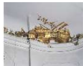
BayNS.II, Deckenstuckdet., Cello, R.1.14, DE001815, BSV-
